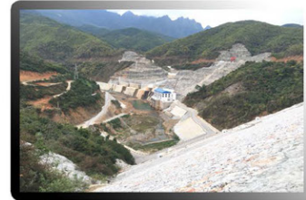
ເຂື່ອນໄຟຟ້ານ້ຳຄານ 2 ກຳລັງຕິດຕັ້ງ 130 MW NAM KHAN 2 HPP, 130 MW
